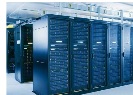
データセンター Data Center
