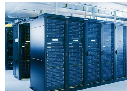
データセンター Data Center
