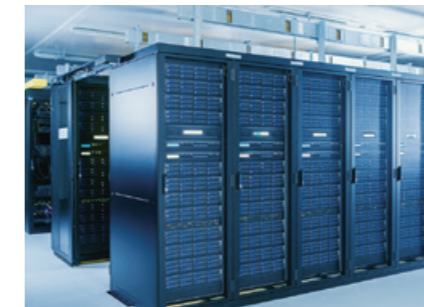
データセンター Data Center
